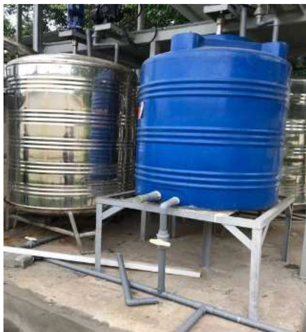
Hình 3. 9. Bồn chứa hóa chất và đường ống, van khóa của Dự án
