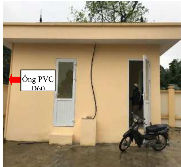
Đường ống nhựa PVC D60 thu nước mái Nhà điều hành thuộc Trạm XLNTSH
