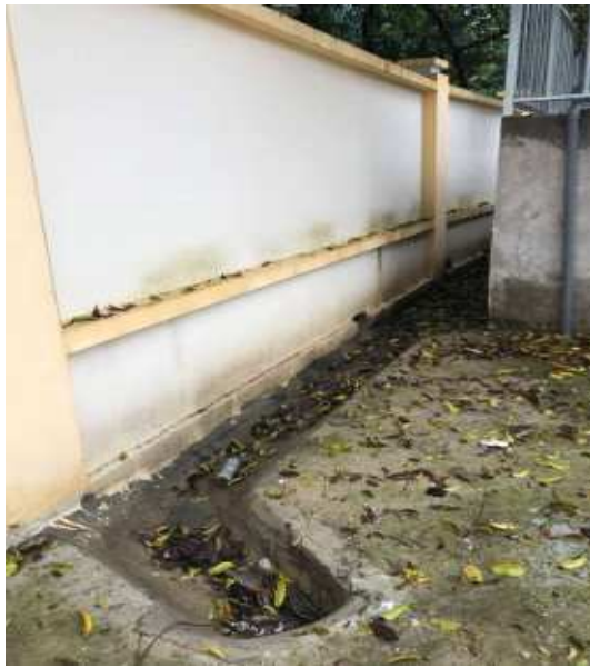
Rãnh thu nước mưa tại Trạm XLNTSH
